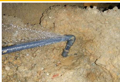
配管接手の抜け
